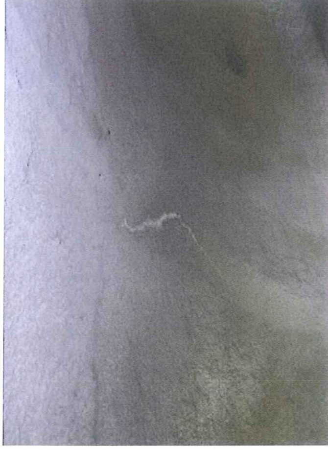
6 trhлина se stopami průsaků v klenbě.JPG
